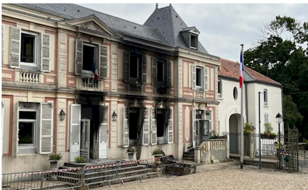
Villeneuve-le-Roi, ce jeudi. A la mairie, les dégâts sont très importants : bureaux détruits, toiture partiellement fondue, mobiliers et documents brûlés, etc. /DR
